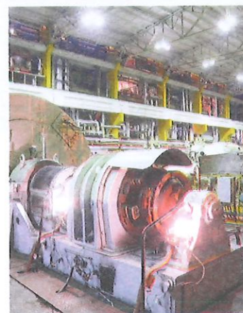
▲ Los generadores son aparatos de grandes dimensiones que son accionados por turbinas hidráulicas, también de grandes dimensiones.
