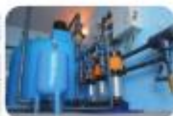
Sistema de filtración de agua.
